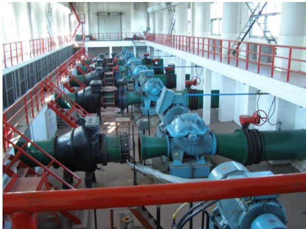
水厂泵站。图片来源：姚福来
