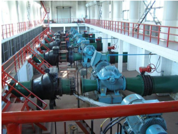
水厂泵站。图片来源：姚福来
